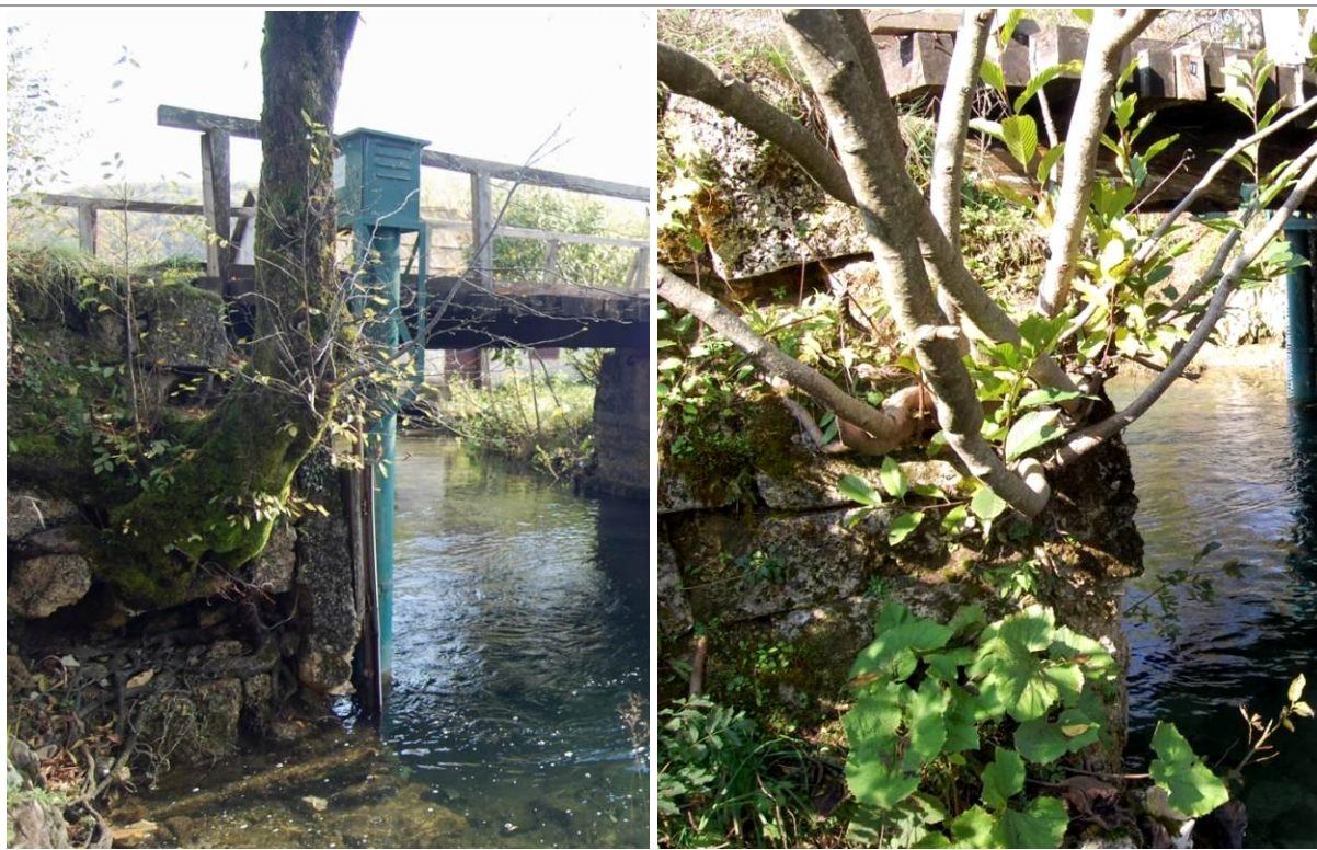
Slika 2.3-3. Kameni zidovi krila obrasli i razoreni vegetacijom. Uzvodno krilo upornjaka prema mjestu Poljanak s pričvršćenom mjernom stanicom za mjerenje vodostaja prikazano je na lijevoj slici, a nizvodno krilo upornjaka prema Plitvica Selu na desnoj slici. (foto: N. Koletić)
